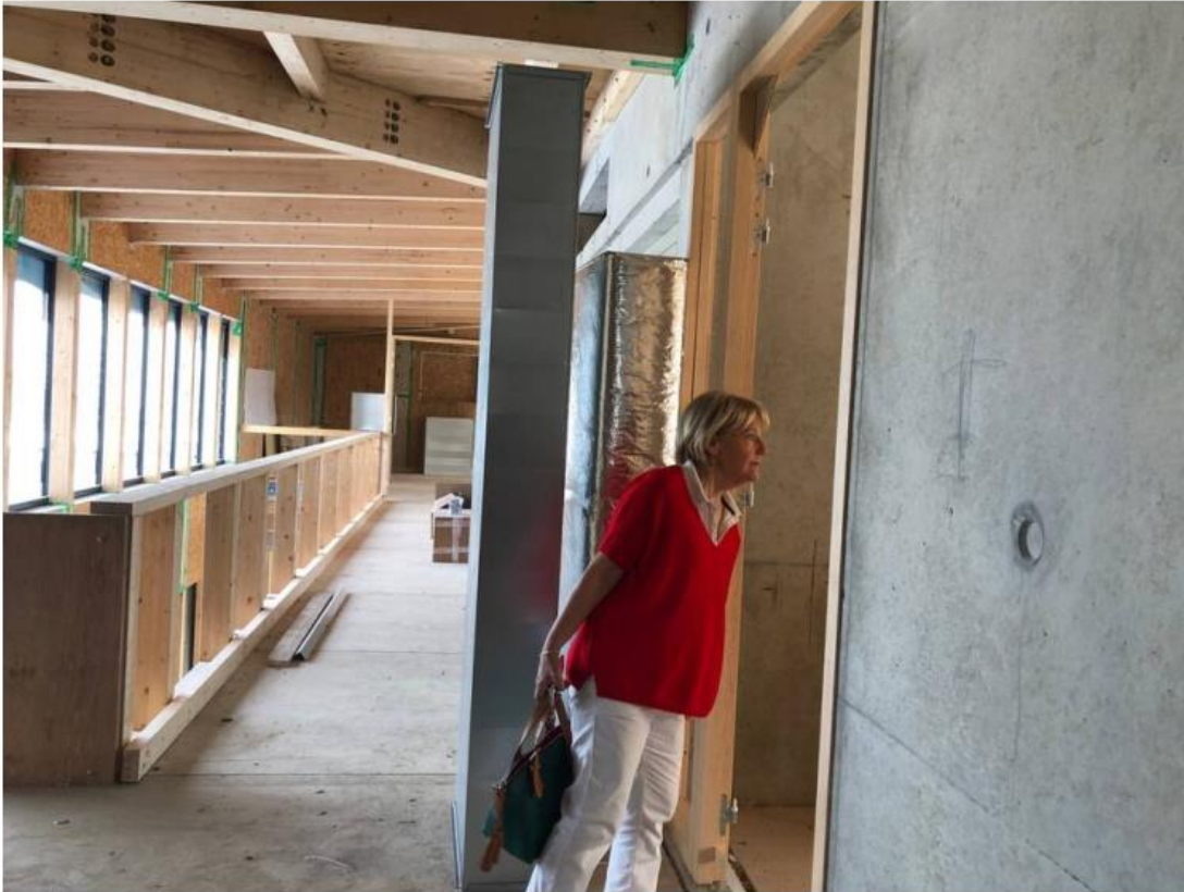
À l'étage, il y aura quatre salles de classe. Brigitte Blévin, adjointe aux affaires scolaires découvre le chantier de la nouvelle école Jean-Nicolas. | OUEST-FRANCE
